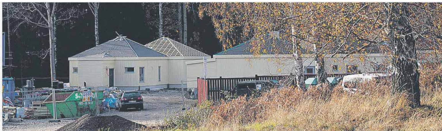
Allt takarbete blev stoppat på byggarbetsplatsen i Skärvik, då Byggnads upptäckte flera brister i arbetsmiljön. Men byggstoppet ignoreras och nu är bygget polisanmält.
