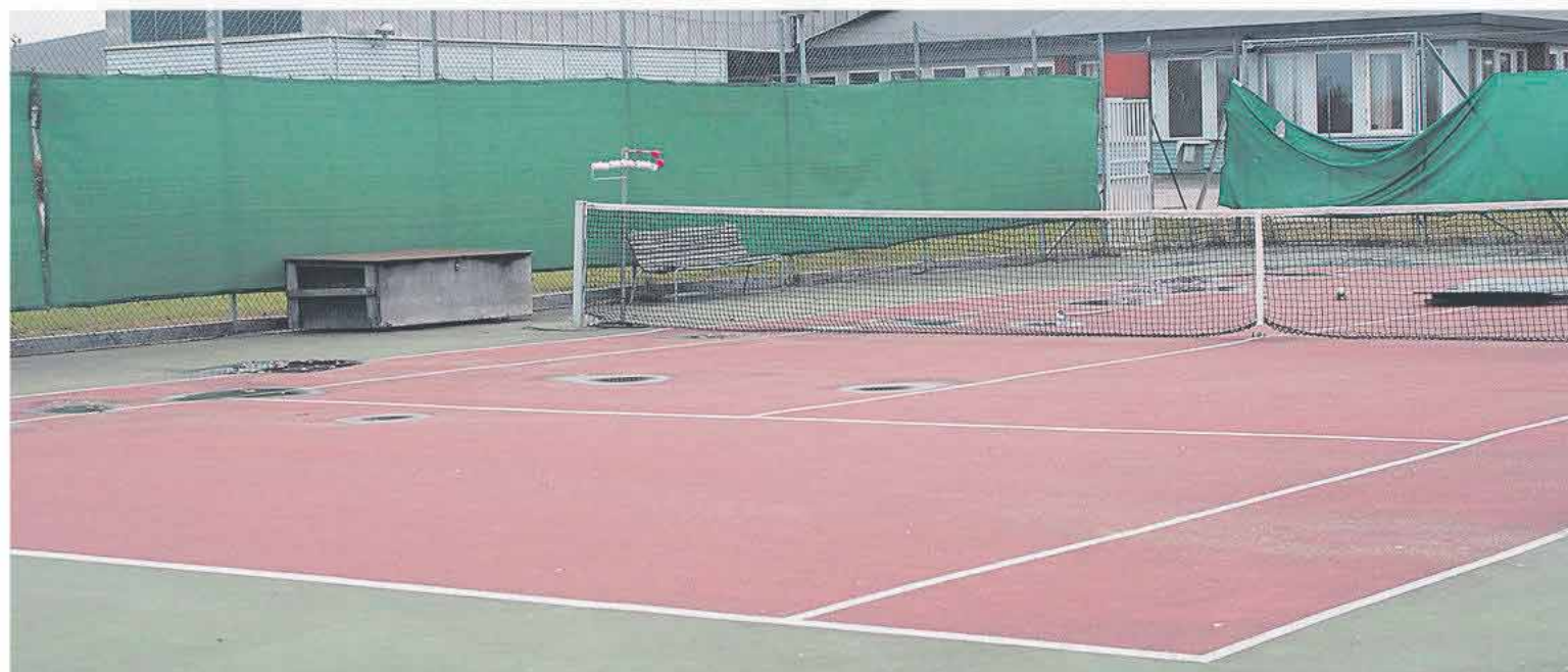
Stenhamra tennisklubbns utebanor behöver renoveras. Kommunen äger banorna men ser det inte självklart att man ska stå för renoveringen.
