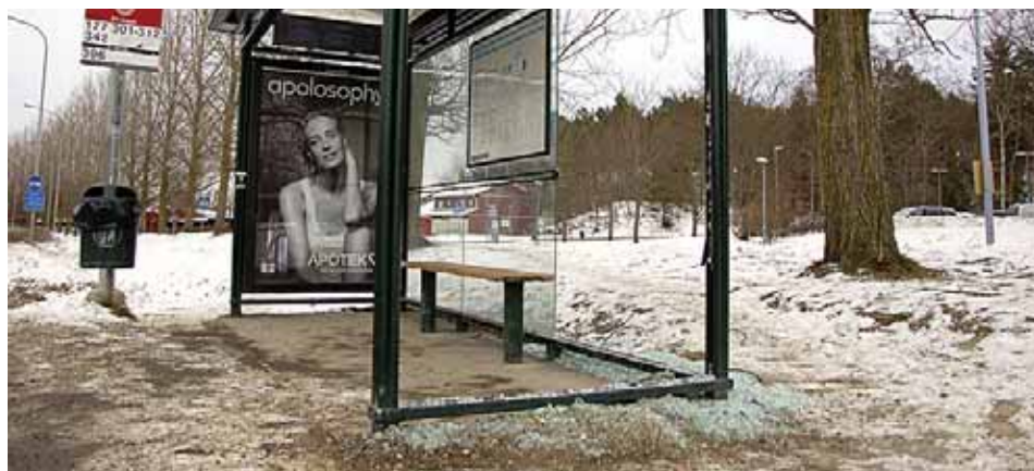
Kostnaderna för glaskross har gått ner under senaste året, men fortfarande blir busskurer sönderslagna. Denna i Ekebyhov vandaliserades i slutet av januari.
