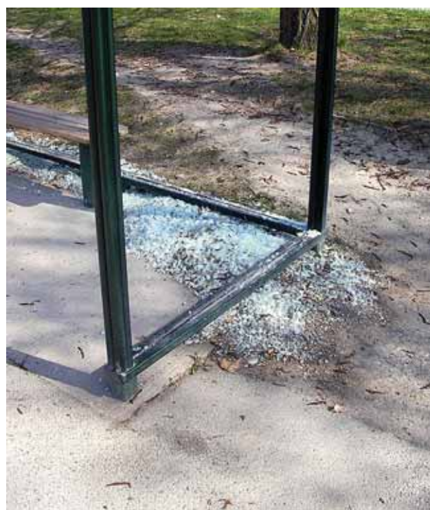
Att laga en vandaliserad busskur kostar mellan 10 000 och 60 000 kronor. Foto: Christer Svanberg
