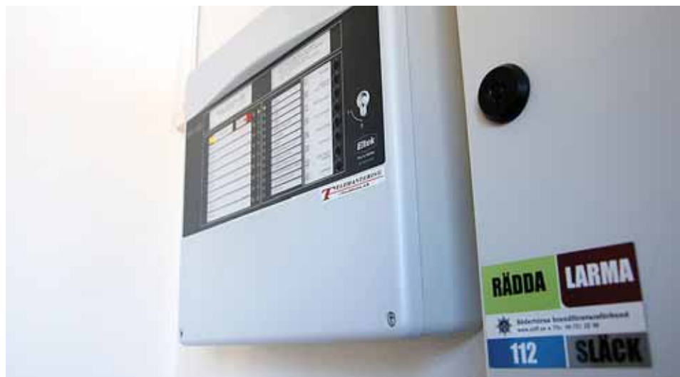
Den tekniska utrustningen är en viktig del av en väl fungerande brandsäkerhet. I 90 procent av kommunens skolor har såväl brandlarmscentraler som utrymningsvägar och rutiner blivit noggrant genomgångna.
