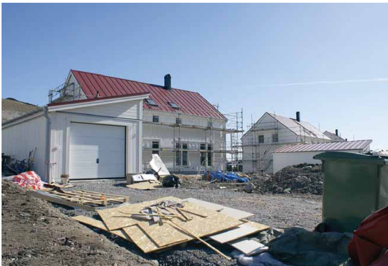
Utanför de nybyggda fastigheterna på Småsvaltingens väg ligger högar av brädor, kapade rör, spik med mera som innebär fara för de inflyttade familjerna och deras barn. Byggstädningen ingick i avtalet och skulle ha skett senast vid tillträdestillfället. Några dagar efter det att Mälaröarnas nyheter intervjuat hustillverkaren, meddelade en av fastighetsägarna att byggstädning påbörjats kring deras hus. Foto: Ewa Linnros
