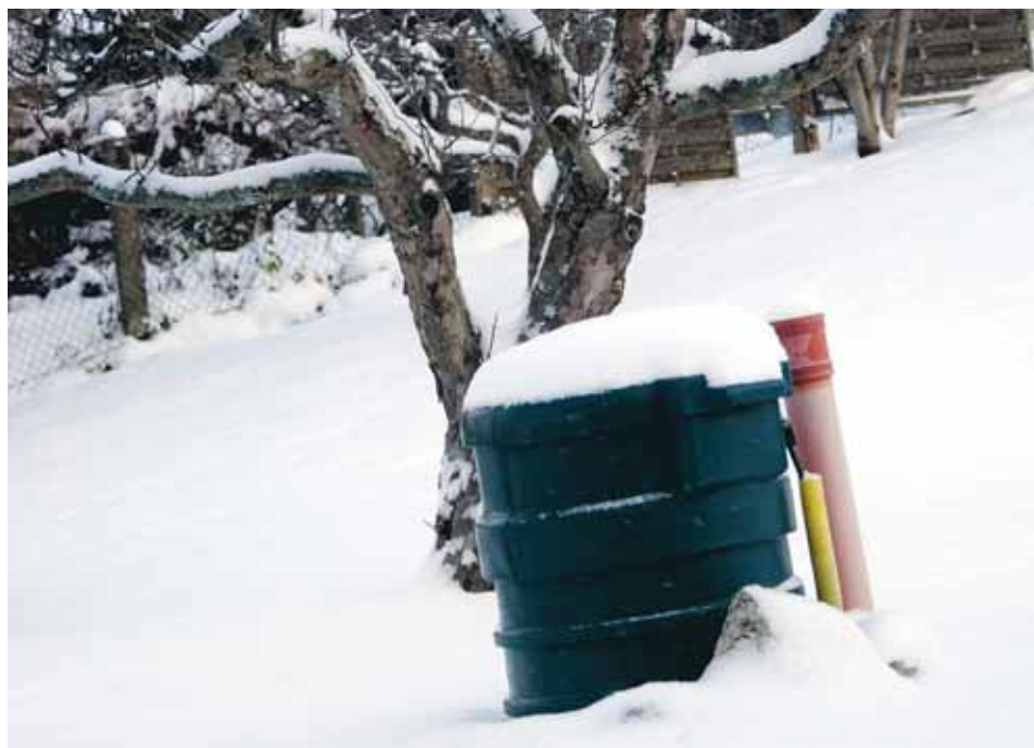
Pumpenheterna som används i LTA-systemet har levererats av kommunen till fastighetsägarna. Före en lagändring 2007 las ansvaret för pumpen och även installationen av den över på fastighetsägaren.
