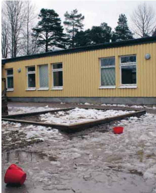
Gräsåkers förskola står tom efter att "gamla" mögelskador återupptäckts. Nu utreder man varför mögelskadorna inte blev fullständigt åtgärdade vid renoveringen för ett par år sedan. Foto: Ewa Linnros
