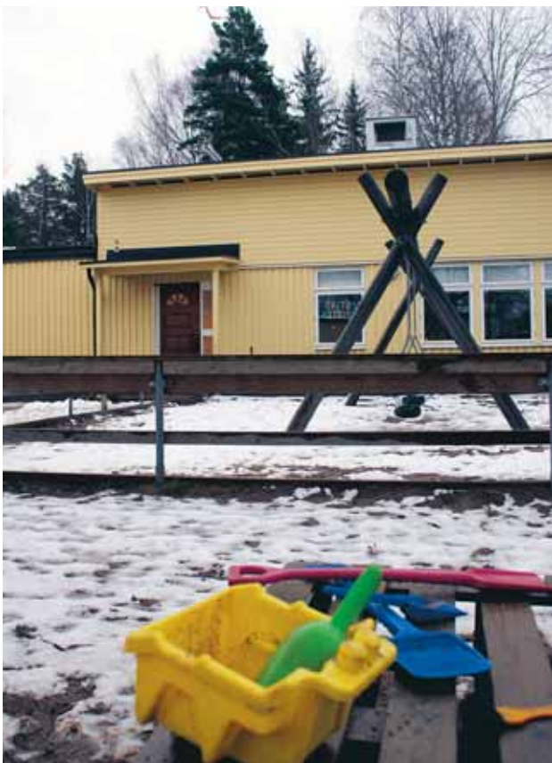
Gräsåkers förskola är evakuerad i väntan på att renoveras. Fuktskador som upptäcktes redan 2007 åtgärdades inte. Vid renoveringen byggdes istället skadan in bakom en ny fasad. Foto: Ewa Linnros
