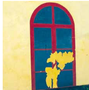
Färgen på byggnadens blindfönster har varit avflagnad i flera år. Foto: Ewa Linnros
