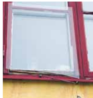
Plexiglas har spikats fast över en del fönster för att rutorna inte ska trilla ur. Foto: Ewa Linnros
