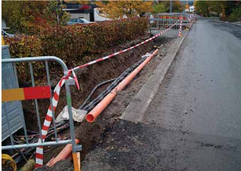
Gropar på byggarbetsplats endast avspärrade med plastband, en risk för både stora och små att falla ner i. Ska det verkligen se ut så här, frågar sig en läsare. Foto: Privat
