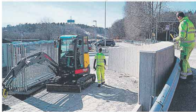
Muren utanför sporthallen saknade bygglov. Nu ska den sänkas. FOTO: EWA LINNROS
