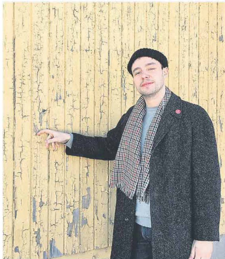
Renoveringsbehov. Fasaden är i stort behov av renovering, säger kulturföreningen Schakalens ordförande Erik Glaad.
